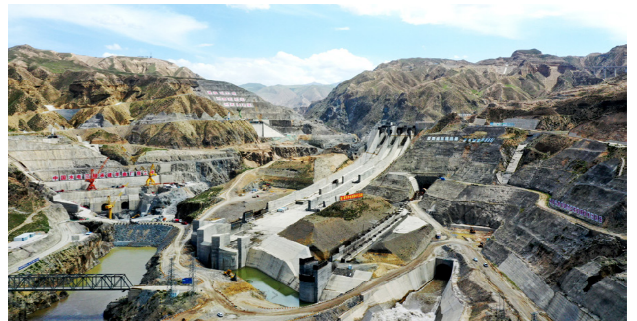
青海省、国家电投的重大项目和海南州千万千瓦级新能源基地的重要支撑电源——羊曲水电站
