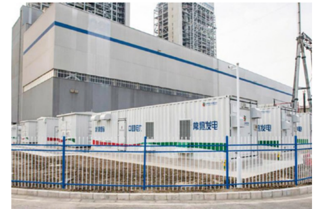
江苏常熟 30W 储能调频电站
